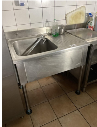
Lot 233 - Une plonge inox simple bac avec égouttoir (robinet cassé)
